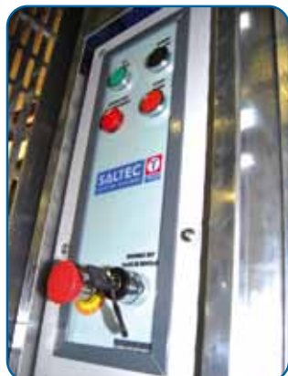
Cuadro eléctrico interior Internal control panel
