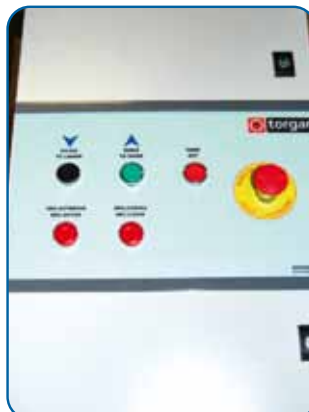
Cuadro de control exterior External control Panel
